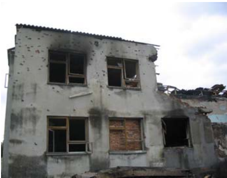
Школа, разрушенная в ходе теракта.
